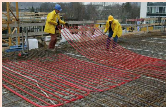
Abbildung 59: Verlegung der Rohrträgermatten einer Bauteilaktivierung (Quelle: Vereinigung der Österreichischen Zementindustrie, Expertenforum Beton, Heizen + Kühlen mit Beton; Foto: Rehau AG).
