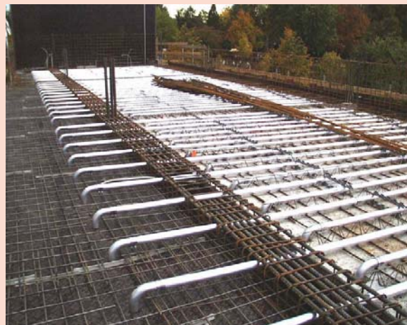
Abbildung 63: Verlegung der Kühlrohre einer luftgeführten Bauteilaktivierung (Quelle: Hildebrand, Kiefer Luft- und Klimatechnik, 2006).
