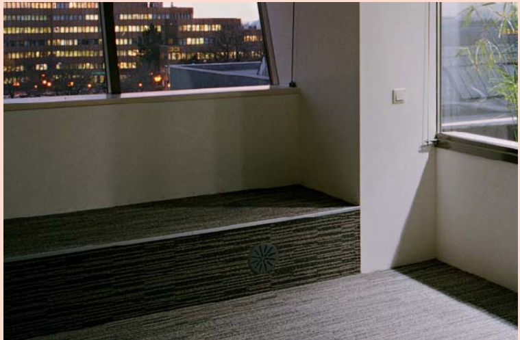
Abbildung 39: Luftauslass für die Quelllüftung im Base, Wien. (Foto: Hertha. Humaus, Architektur: pos architekten).
