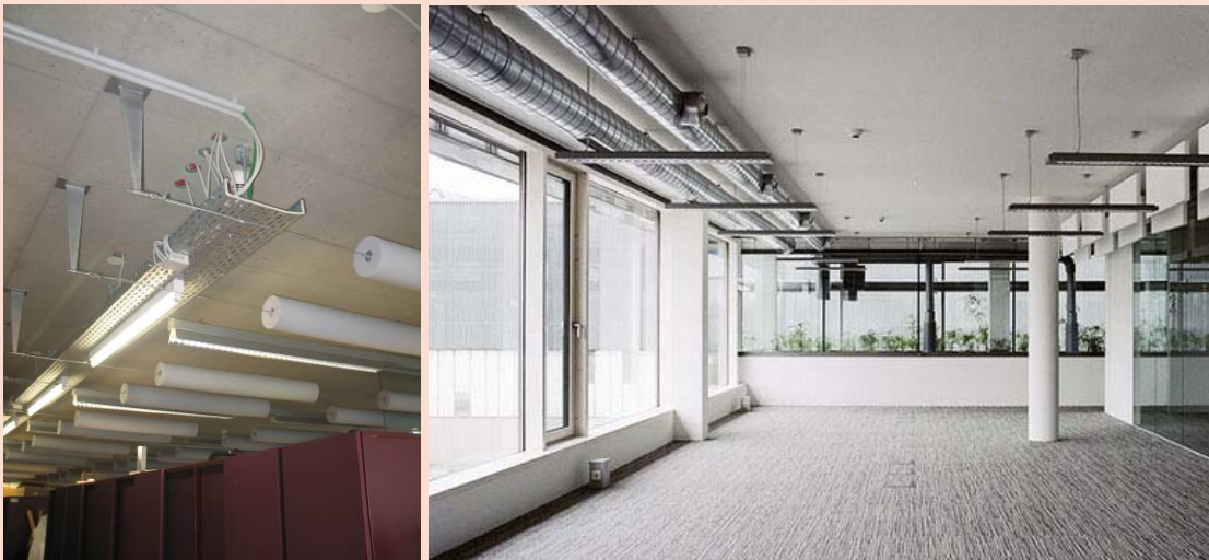
Abbildung 33: Sichtbetondecke mit oberflächlicher Verlegung der Beleuchtung, der Lüftungskanäle Rauchmelder sowie Akustik-Baffles. Links: Neubau Donau Universität Krems (Foto: Peter Holzer), Rechts: ENERGYbase, Wien (Foto: Hertha Hurnaus, Architektur: pos architekten).
