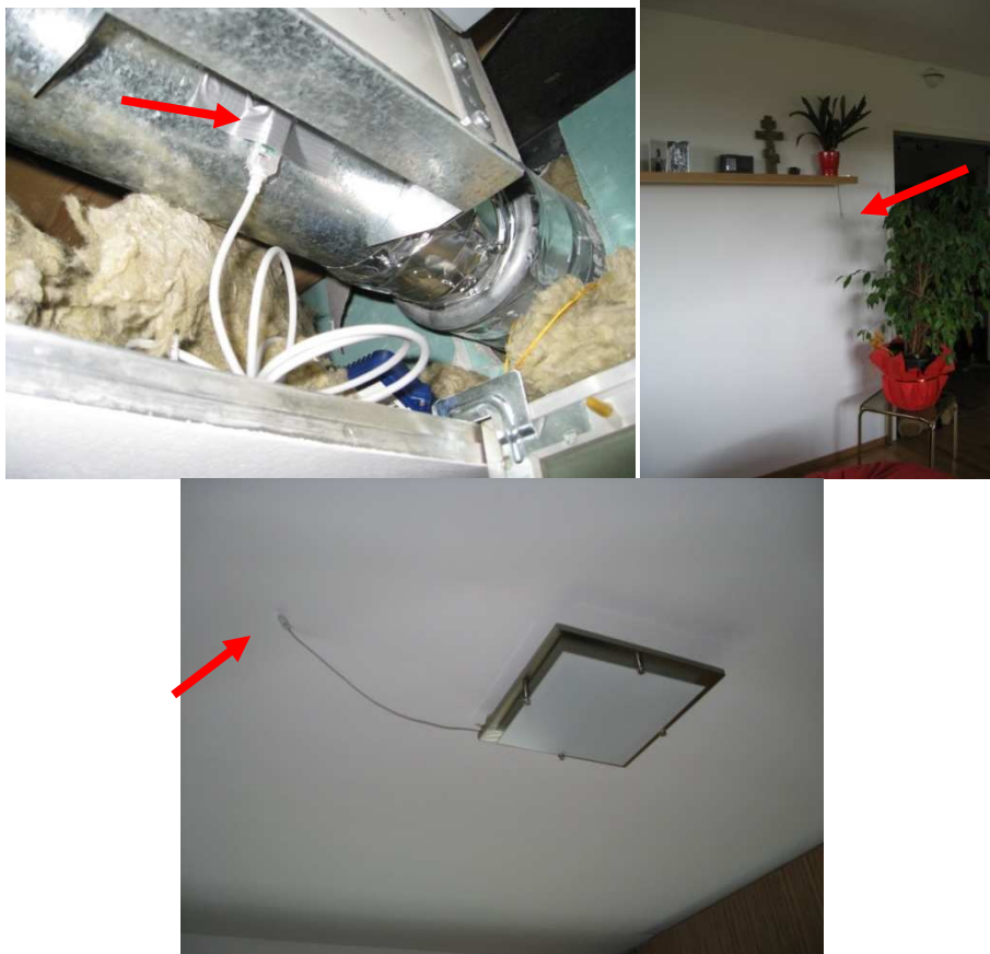
Abbildung 2: Positionen der Sensoren in der untersuchten Wohnung im Passivhaus Mühlweg. Links oben: Zuluft. Rechts oben: Wohnzimmer. Unten: Schlafzimmer.
